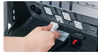
③コンセントに電気機器のプラグを挿して使う Photo: Power Exporter e: 6000
