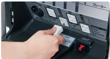
③ コンセントに電気機器のプラグを挿して使う
